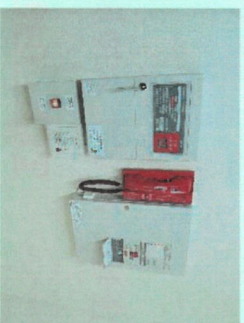
非常放送設備
